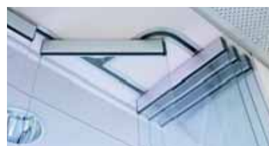
Intégration esthétique du rail de roulement dans le plafond avec le cache de l'espace de parquage.
